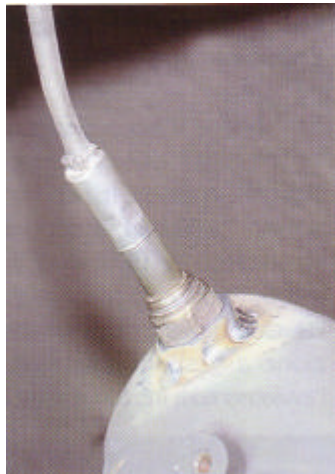
Figura I.29 Dettaglio della sonda lambda installata al termine della linea di scarico
