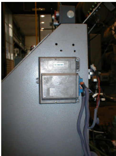
Figura IV.20 Centralina montata sul pulpito
